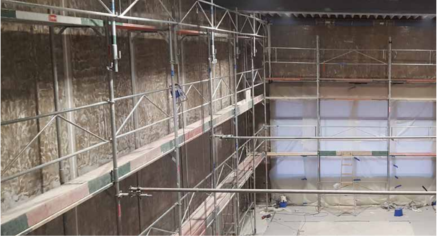
Bild 1: Nach Einrüstung der gesamten Wandfläche konnte mit der Sanierung der fehlerhaften Betondeckung der Fertigteilelemente begonnen werden
